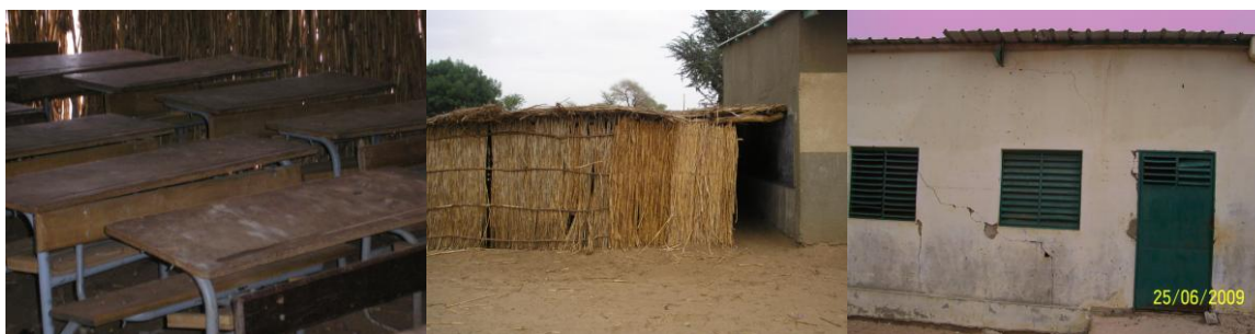
Photo 9 : Abri provisoire et salle de classe dégradée
