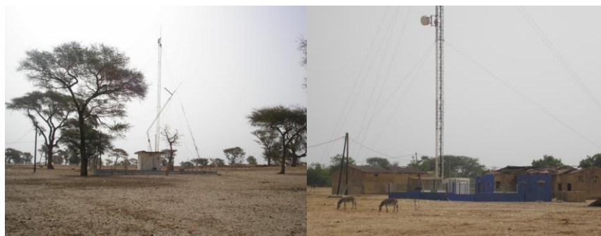
Photo 5 : antennes orange (cassée) et tigo à Peye Ngoye
